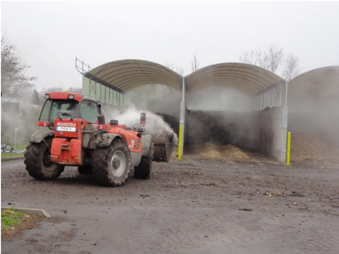
site de compostage – Station d'épuration du Rosenmeer (67)
