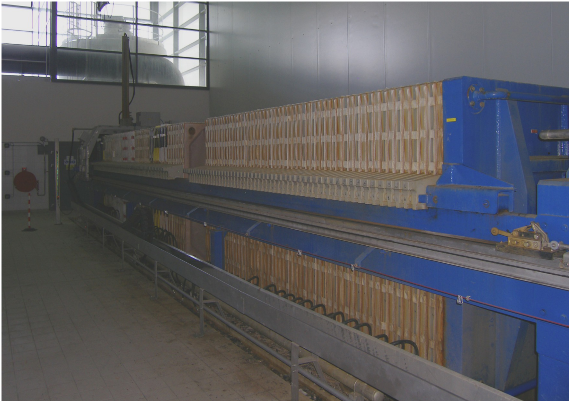
Filtre Presse de la station de Limoges (87)
