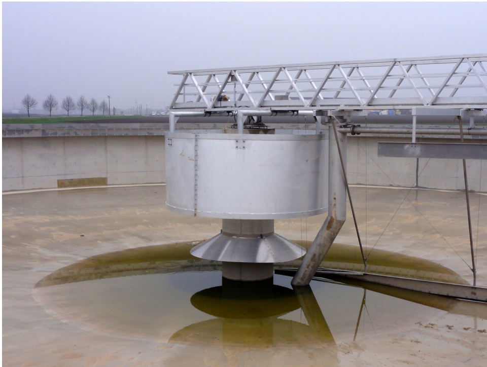
Jupe de répartition d'un clarificateur secondaire - Station de Meistratzheim (67)
