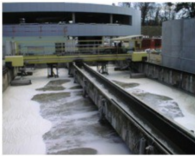
Image 15 Dégraisseur dessableur aéré
