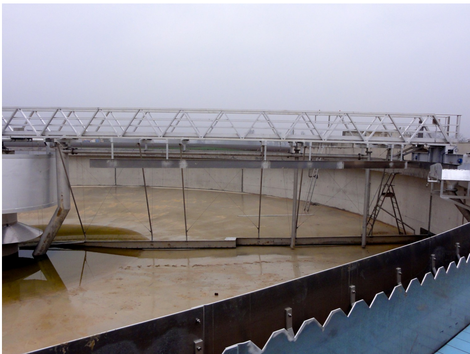
Pont racleur-suceur sur un clarificateur secondaire - Station de Meistratzheim (67)
