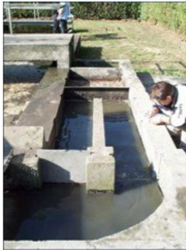
Dessableurs couloirs ou canaux (petites stations)
