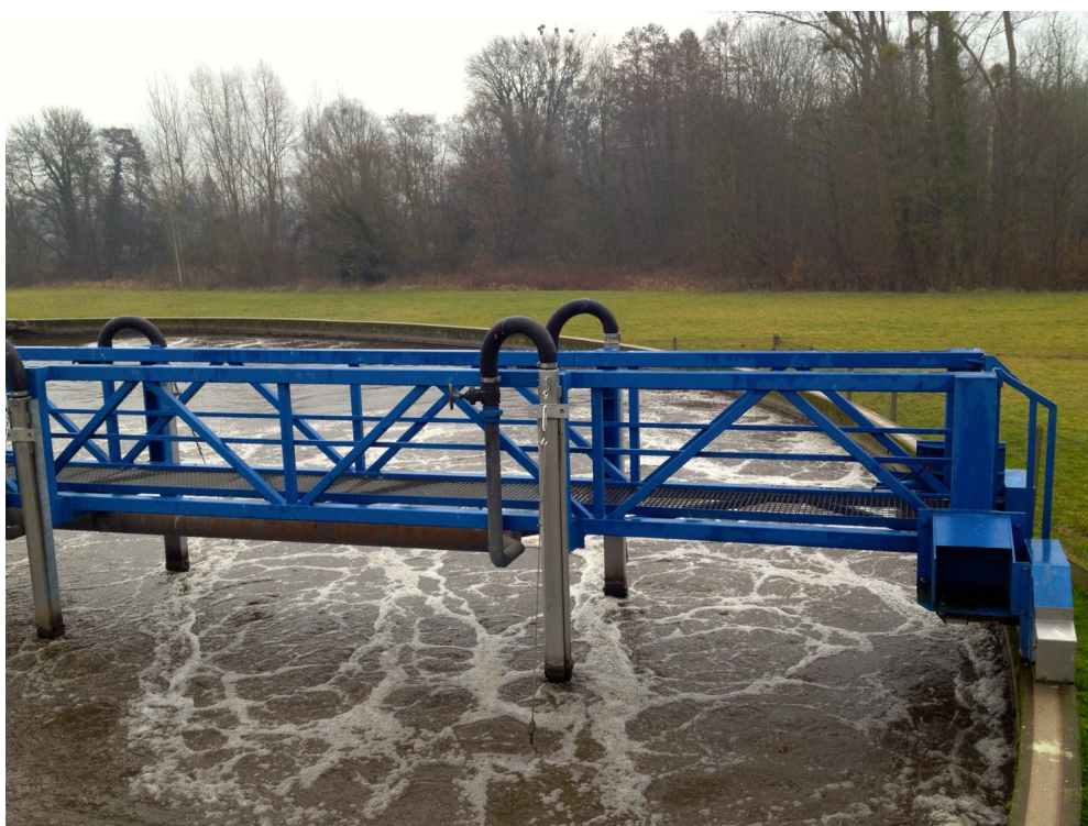
Bassin d'aération de la station de Fegersheim (67)
