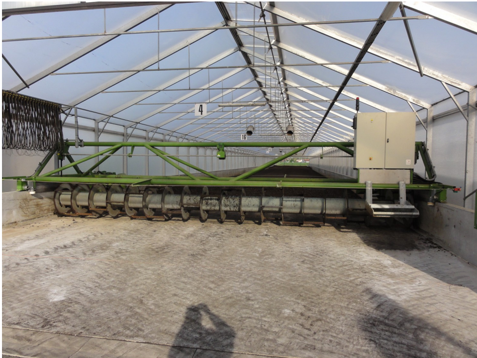
Serre ouverte de séchage solaire de la station de Brumath (67)
